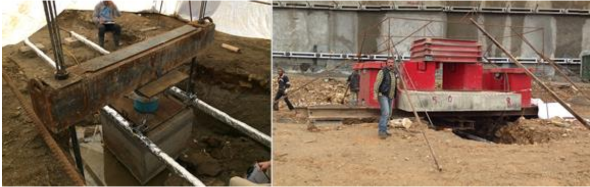
Şekil 11. Ankrajlı ve Ölü Yük ile Teşkil Edilen Jet Grout Kolon Yükleme Testleri
